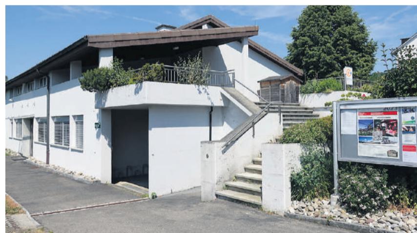
Sanierungsbedarf: Das Dach des Gemeindehauses/Kindergartens bietet heute eine schlechte Wärmedämmung.
